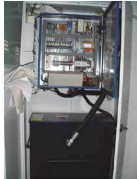
Detalle del armario de maniobra y central hidráulica
