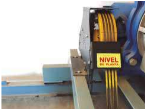
Detalle del marcado de los cables a nivel de planta
