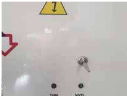
Detalle de ascensor a nivel armario maniobra cerrado
