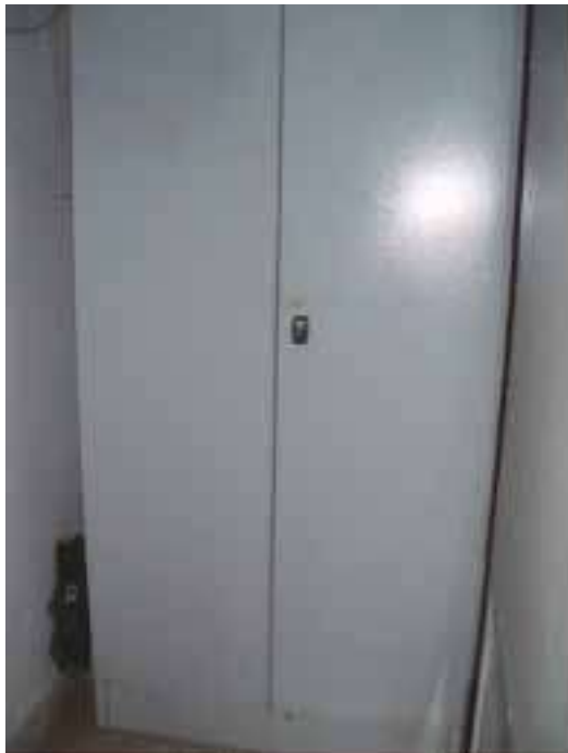
Cuarto de máquinas ascensor hidráulico
