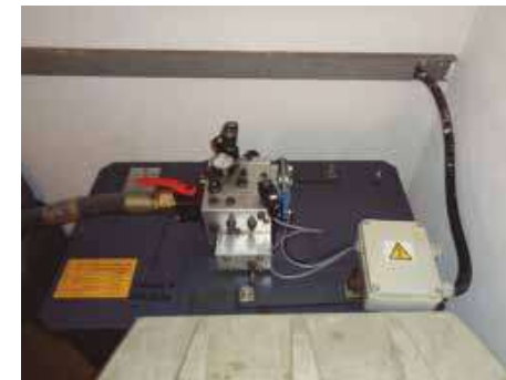
Detalle de elementos de la central hidráulica
