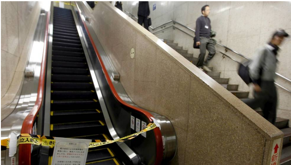
Escaleras mecánicas averiadas en una estación de metro. (EFE)
